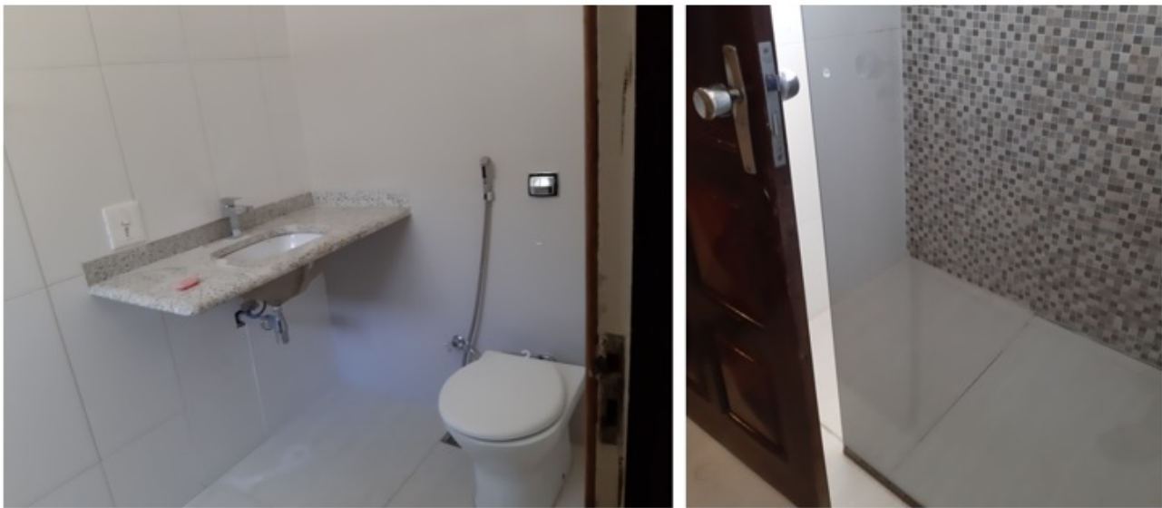
Fig. 17: WC 2/ Vidro temperado vulnerável à maçaneta
