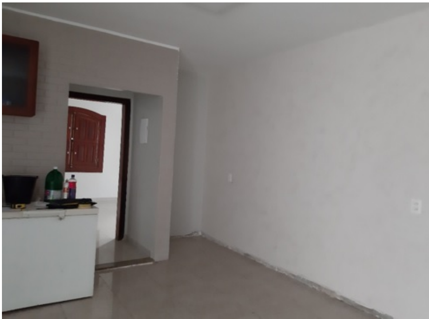
Fig. 10: Cozinha/ faltando rodapé e pintura na parede
