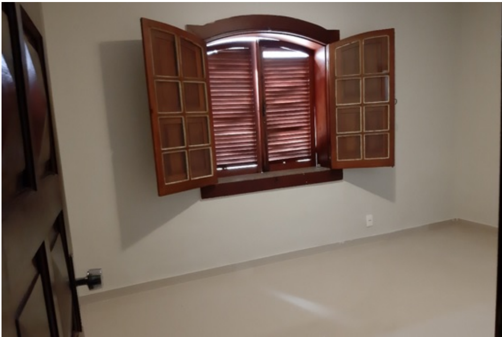
Fig. 15: Quarto 4/ folhas de veneziana em madeira faltando peças e com problema de fechamento
