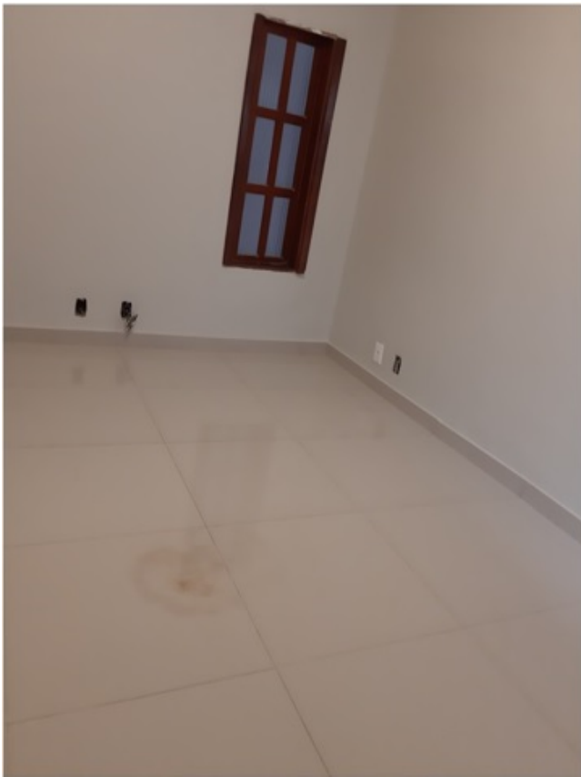
Fig. 11: Quarto 1/ falta instalar porta de entrada instalada
